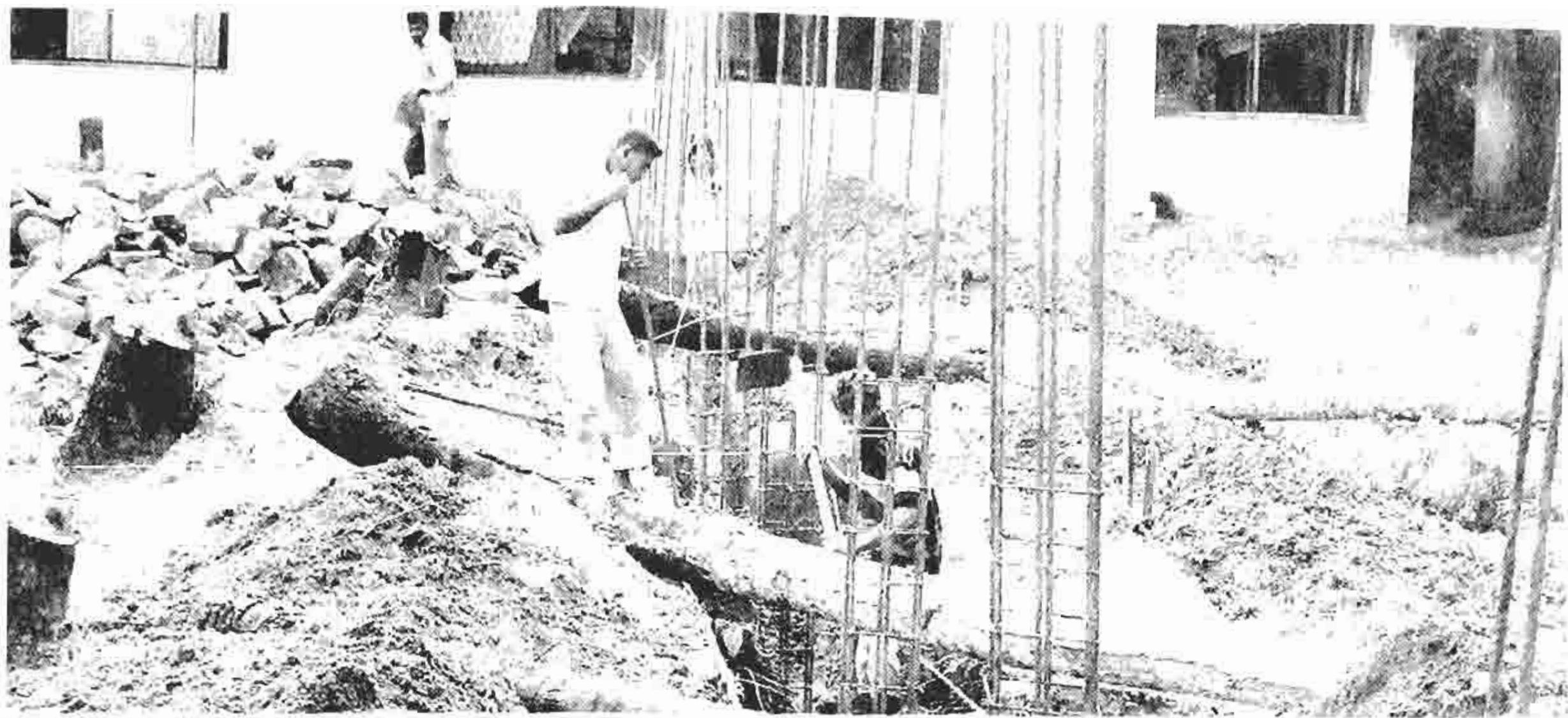
Bei 35 Grad im Schatten fertiggestellt: Wiederaufbau einer Schule im Katastrophen-Gebiet auf Sri Lanka.
